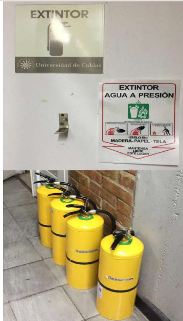
Ilustración 24. Extintor Clase A
