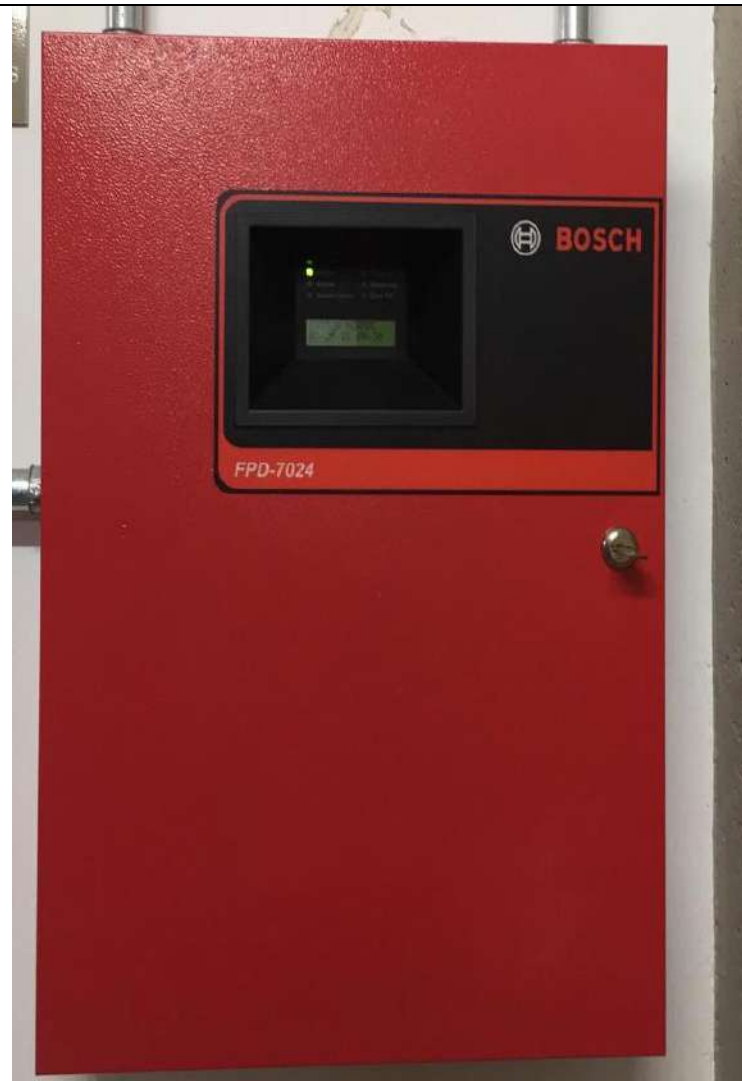
Ilustración 3. Sistema de Detección de Incendio del Archivo Central
